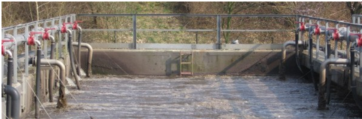
Figure 2 : photographie de la première partie du chenal d'oxydation de la station d'épuration de Gembloux où les boues recirculées (brun foncées) sont mises en contact avec l'eau usée qui a subi le traitement primaire.
