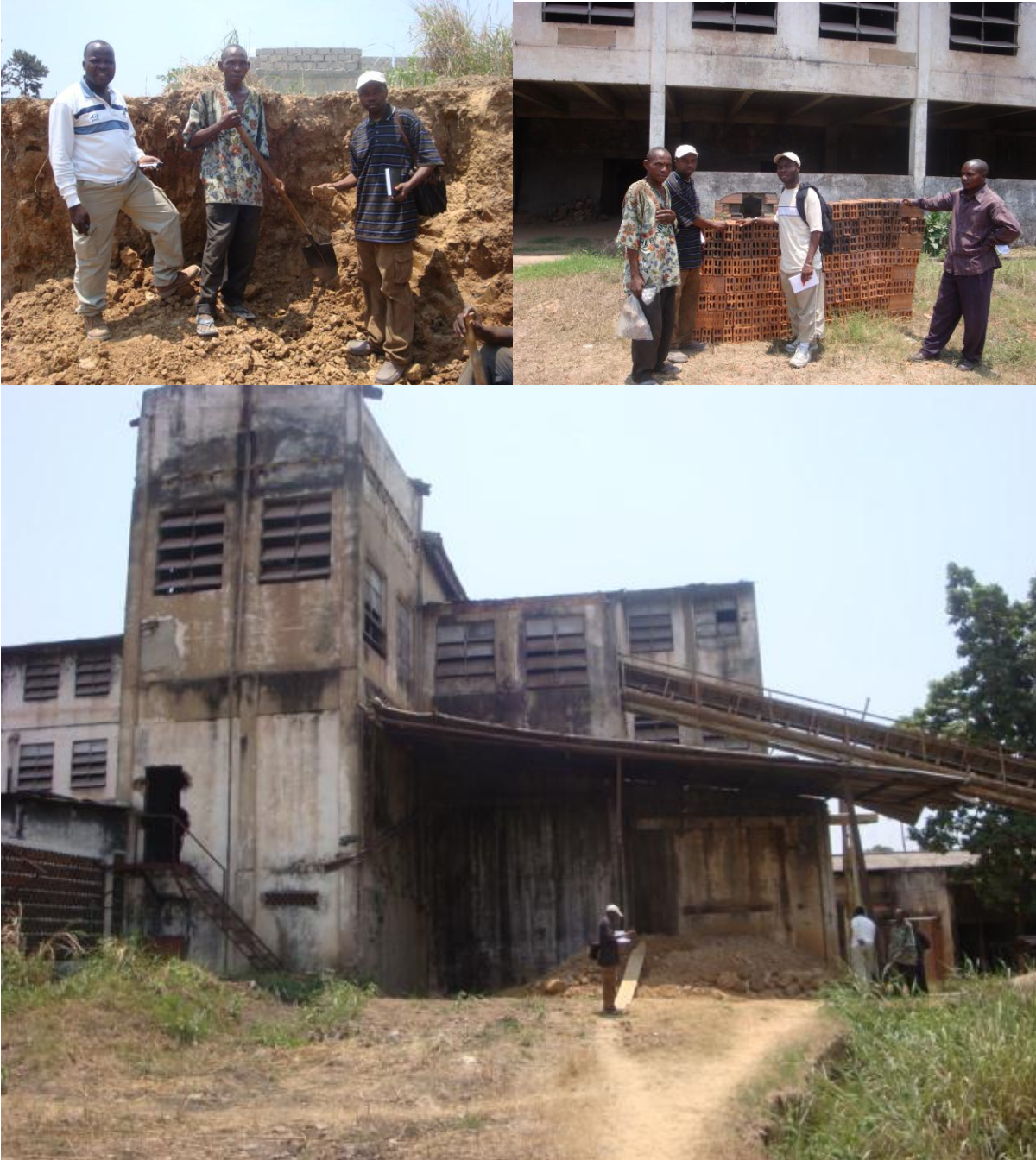
Fig. 47: Une vue désolante de l'usine de Brikina attestant sa vétusté
