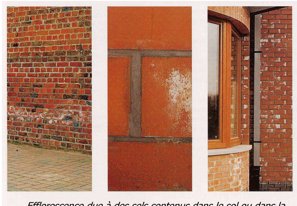
Efflorescence due à des sels contenus dans le sol ou dans la terre cuite (source Febelcem)
