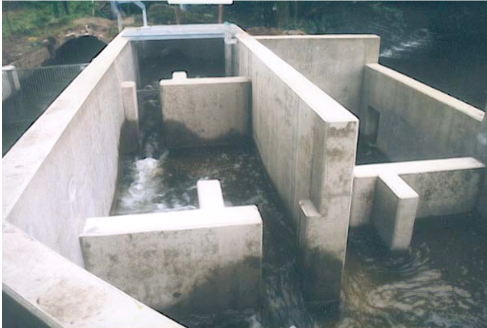
Photo 11: Vue de l'échelle à poissons du barrage de Mortoux montrant la disposition des bassins et le dispositif de piègeage des poissons (cône) dans le bassin supérieur.
