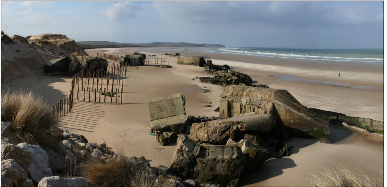
Ici, l'érosion du cordon de dunes sur lequel étaient construits ces blochauses du mur de l'Atlantique a provoqué l'effondrement de ceux-ci. Leur masse a cependant permis qu'ils restent sur place.
