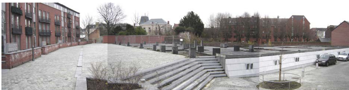
L'aménagement de la nouvelle place avec, au second plan, les fondations de l'immeuble à construire par le promoteur.
