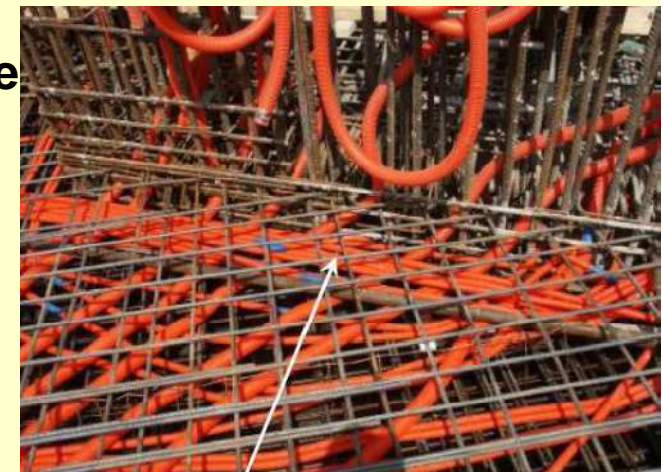
Gaine électrique & chauffage
