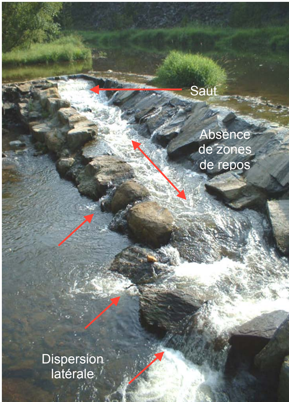
Photo 1 : Vue de l'échelle à poissons en enrochements et des ses principaux défauts
