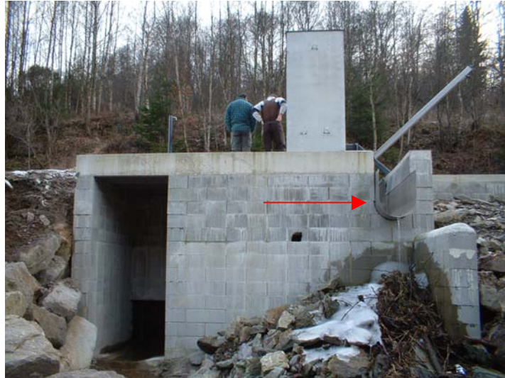
Photo 2 : Vue du dégrilleur et de son exutoire de nettoyage dont la configuration ne permet pas aux poissons dégrillés de retourner vivants vers le cours naturel de la Lhomme
