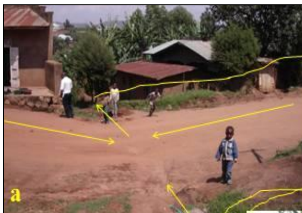
Figure 4. 13. Route Kisingiri-Mukuna : point de débordement de la route fonctionnant en corniche.
