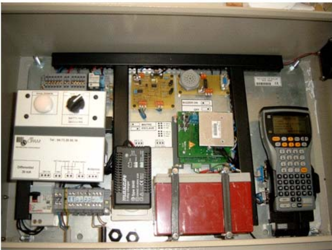
Planche photos 7 : En haut : vue de l'antenne de détection CIPAM placée dans le dernier bassin amont, juste avant la cage de capture. En bas : boîtier électronique de détection CIPAM placé dans le chalet en bois.
